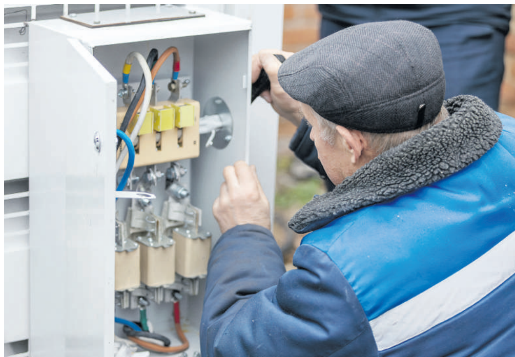
В Белгороде делают всё, чтобы обеспечить жителей бесперебойным электроснабжением
